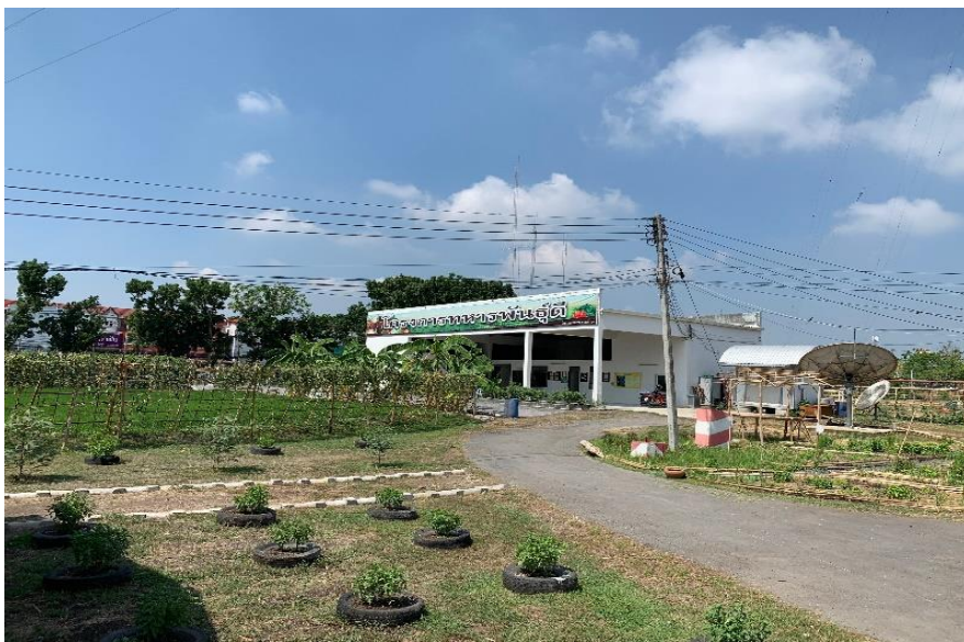
ภาพที่ 7 จุดติดตั้งระบบสูบน้ำระบบโซลาร์เซลล์ แบบชุดปั๊มสูบน้ำเพื่อแปลงเกษตร โครงการทหารพันธุ์ดี (Solar Pumping System)
