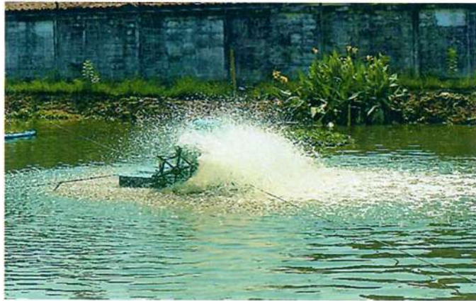
ภาพที่ 2.3 เครื่องเติมอากาศในการทดลองบำบัดน้ำเสียหน้ากองวิทยาการ
