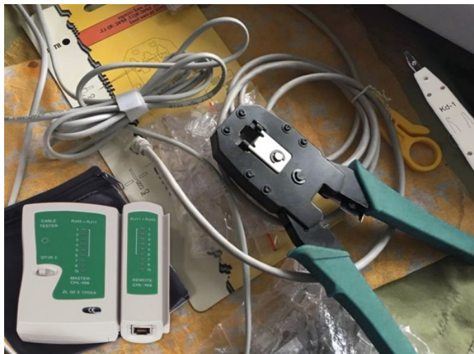
รูปภาพที่ 7 การทดสอบสายสื่อสารในเครือข่ายระบบ BAS
